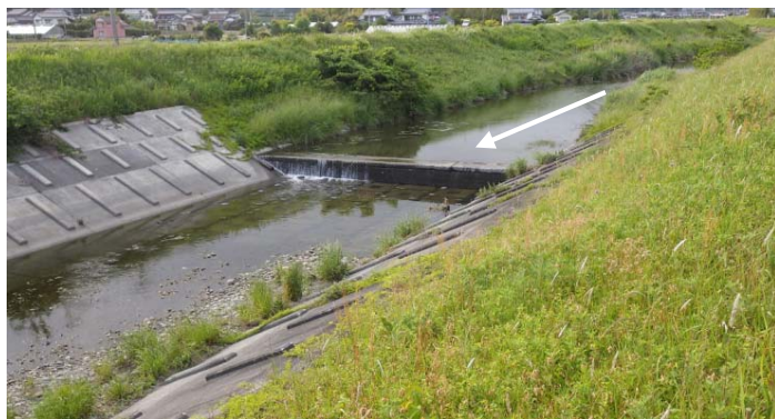
落差が大きいため、魚類の遡上が困難な床止めの例 (下小笠川 3.1k付近 7号床止め(落差 約0.7m))
