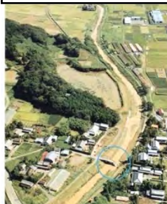
丹野川 赤土橋の落橋
