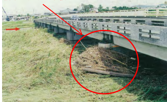
菊川 2.1k付近 国安橋 (H16出水撮影)
