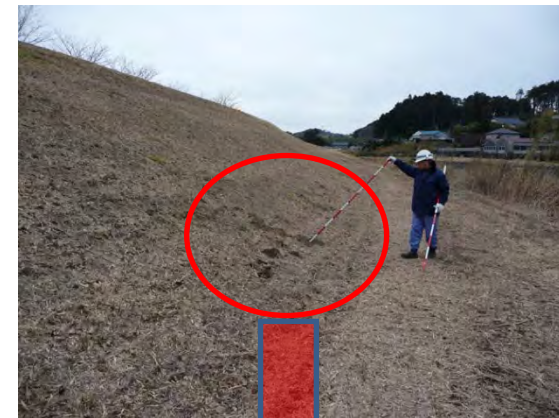
もぐらによる堤防損傷状況
