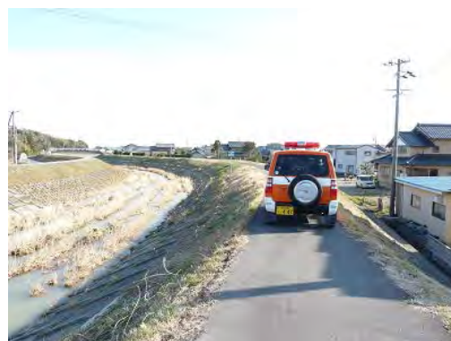
下小笠川 4k0付近右岸 堤防天端幅が狭い状況
