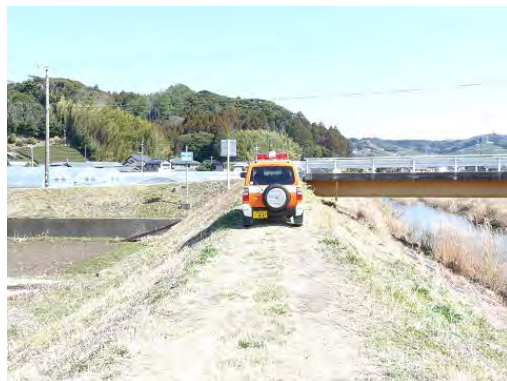
牛淵川 10k7付近右岸 堤防天端幅が狭い状況
