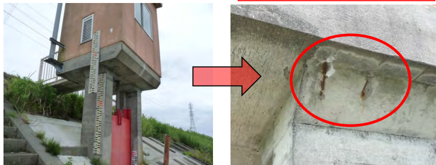
樋門が損傷した事例（鉄筋露出）
