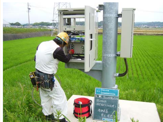
堂山水位観測所 河川監視カメラ点検状況
