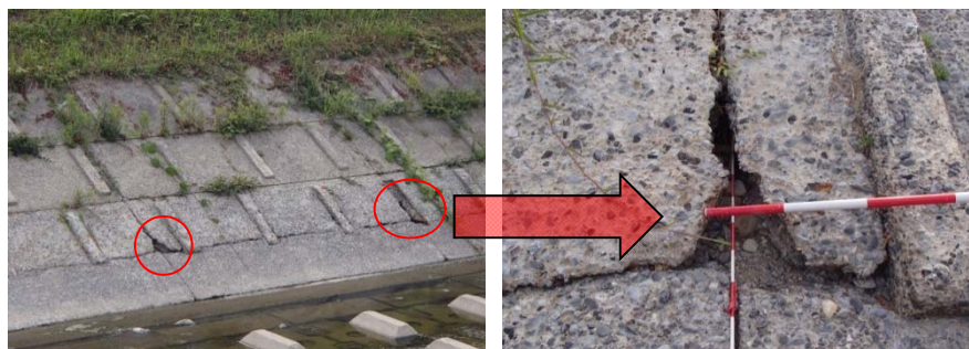
土砂の吸い出しによる空洞及び護岸の浮き上がった事例
