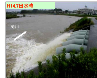
与惣川排水機場からの排水状況
