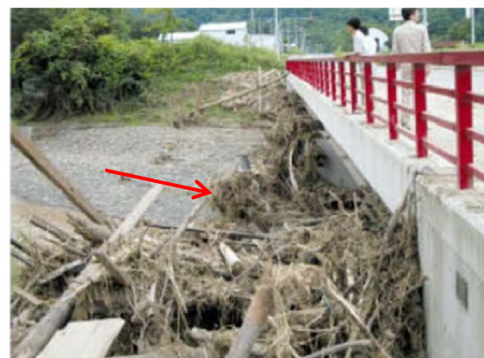
流木が詰まり流下阻害が生じている事例
