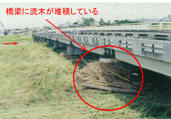
菊川 2.1k付近 国安橋 (H16出水撮影)
