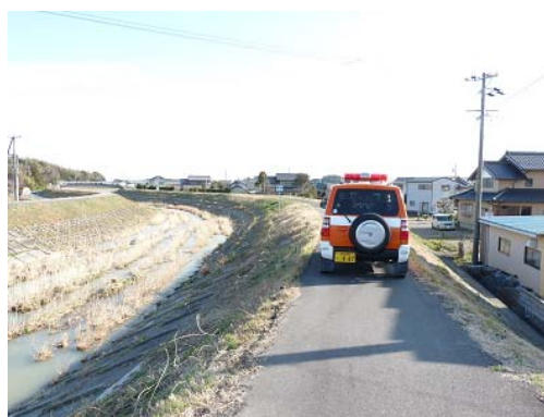
下小笠川 4k0付近右岸 堤防天端幅が狭い状況
