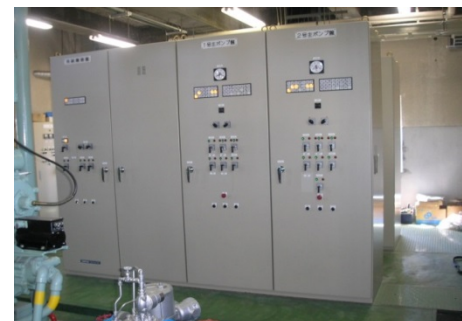
黒沢川排水機場 ポンプ制御設備
