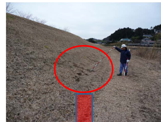
もぐらによる堤防損傷状況
