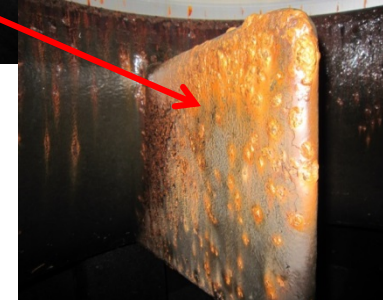
渦流防止板の発錆状況
