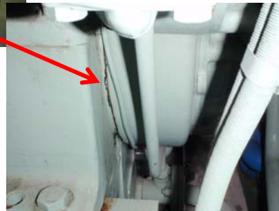
黒沢川排水機場 2号原動機 油漏れ状況
