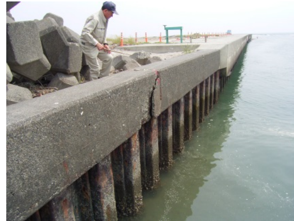
安全点検によりクラックが確認された河川管理施設
