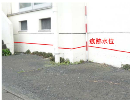
黒沢川 0.5k付近左岸の浸水状況
