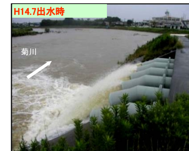
与惣川排水機場 からの排水状況
