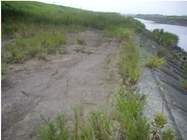
3k8右岸 高水敷 露出・風化状況
