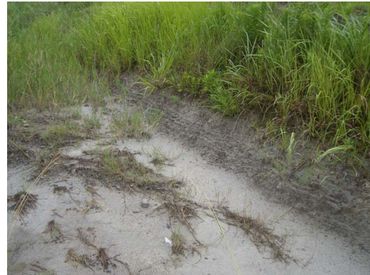
4k0左岸 堤防法尻 露出・風化状況
