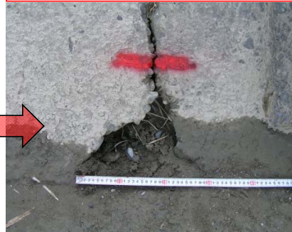
低水護岸にクラックが生じた事例
