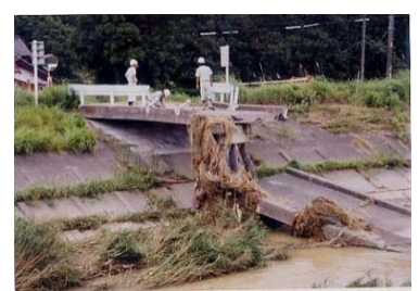
平成10年9月洪水 下小笠川 第二城東橋の落橋 （掛川市下土方、下小笠川4k2付近）
