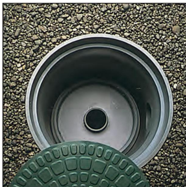
写真 4 浸透ますの事例
