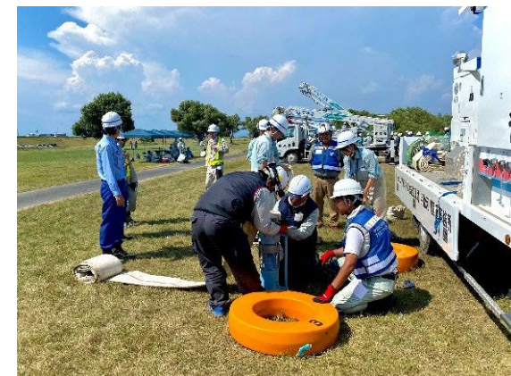
排水ポンプのホース設置準備状況 (令和5年度)
