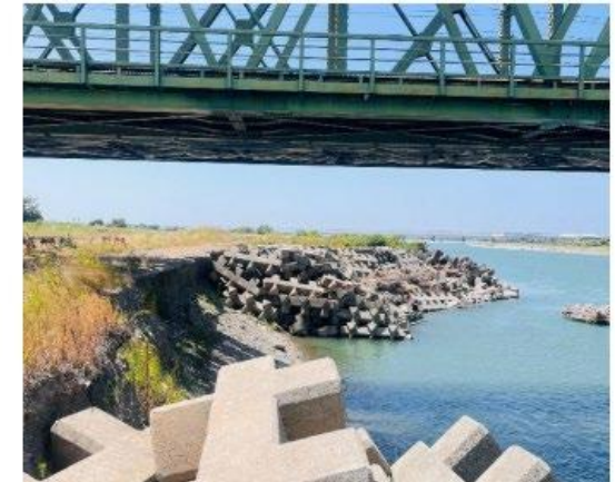
河岸侵食箇所の様子
