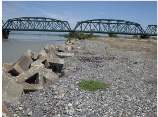
写真 6-17 左岸 7.8km の根固工の状況
