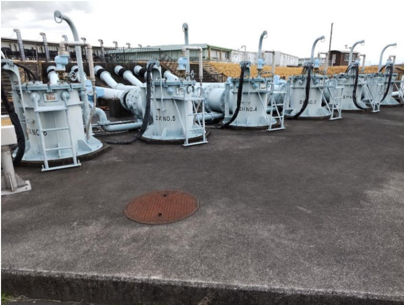
排水ポンプ全景
