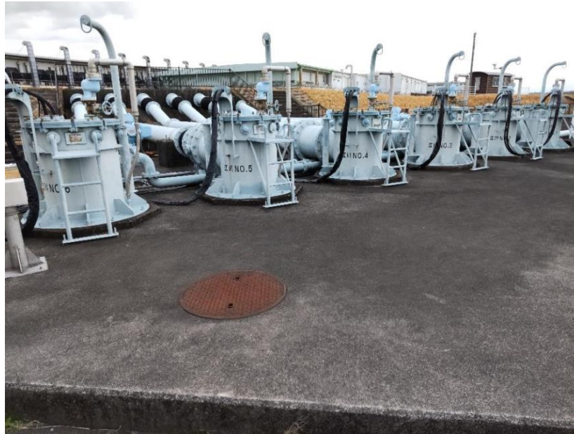
排水ポンプ全景
