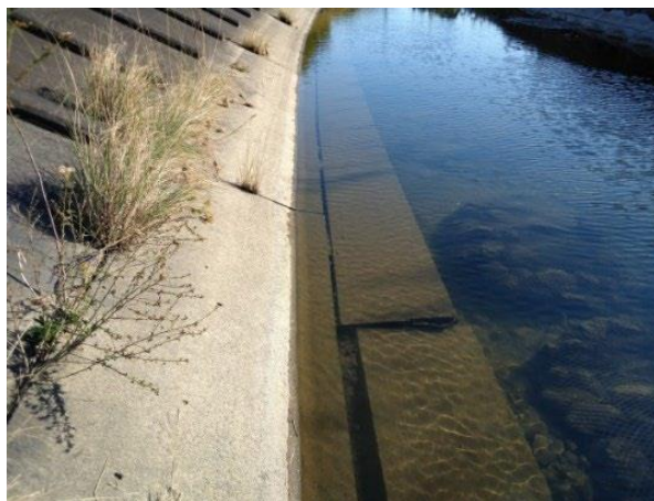
写真 6-2 下小笠川左岸 2.4 km 付近の局所洗掘による目地開き (令和 4 年度時点)
