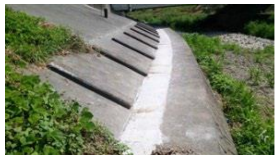
写真 6-13 基礎工付近の護岸補修箇所
