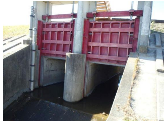
写真 5-7 機械設備を伴う河川管理施設
