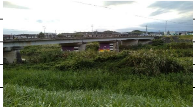
加茂橋橋脚、水位計③④
