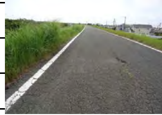
アスファルト亀裂段差あり
