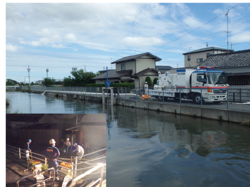
排水ポンプ車設置状況
