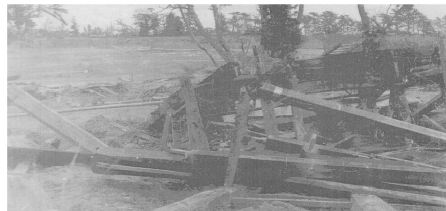
天竜川西派川堤防決壊直後の家屋の倒壊状況(浜松市南区金折町)
