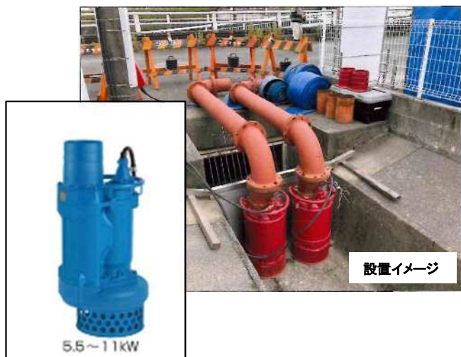
■緊急時のポンプ排水(可搬式ポンプ購入7台)
