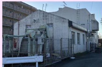
鳥之瀬排水ポンプ場
