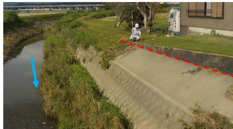
洪水痕跡（清水橋上流）
