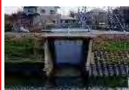
逆流防止施設の整備 (浜松市)
