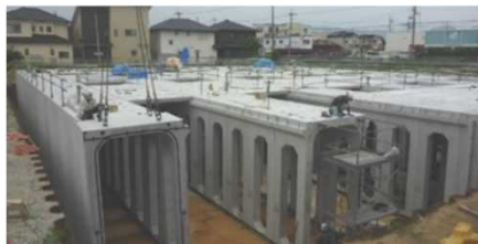
駐車場の地下に雨水貯留施設を設置した事例（奈良県）
