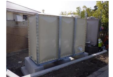
防災施設 (貯水タンク)
