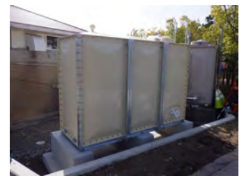
防災施設（貯水タンク）
