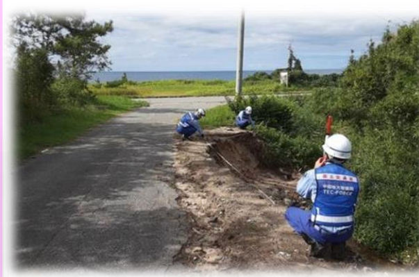
豪雨による道路被災状況
