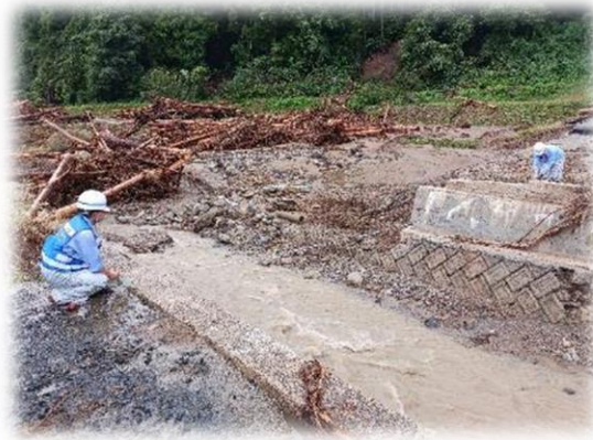
豪雨による橋梁被災状況
