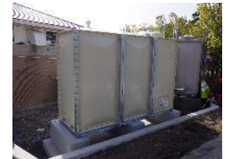
防災施設（貯水タンク）
