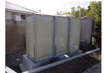
防災施設（貯水タンク）
