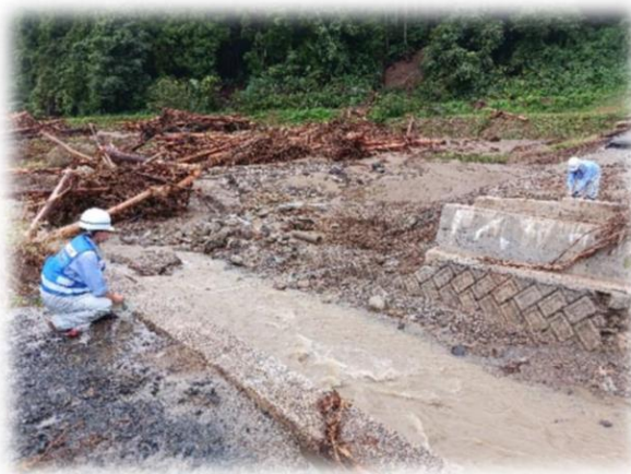
豪雨による橋梁被災状況
