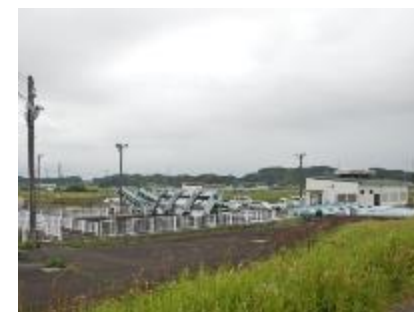
江川救急内水排水機場
