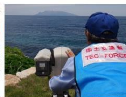
監視カメラの設置
