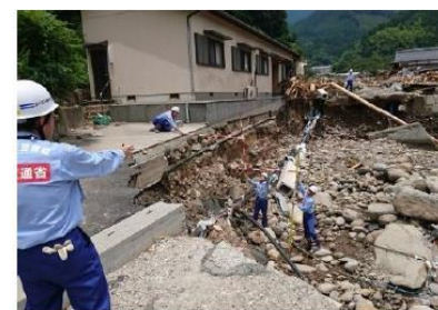
河川被害状況の調査
