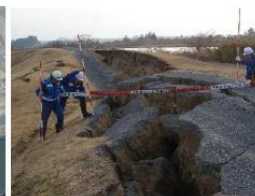
堤防被害状況の把握
