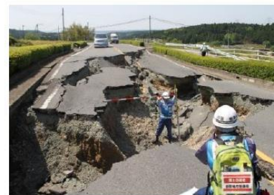
道路被害状況の調査
