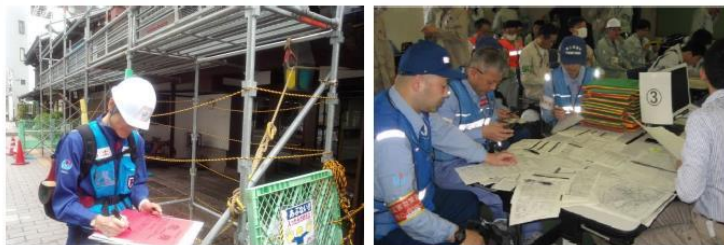
被災建築物の応急危険度判定 (平成28年熊本地震)
