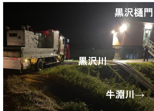
排水ポンプ稼働状況
