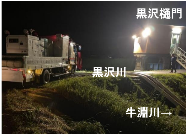
排水ポンプ稼働状況
