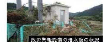
放流警報設備の浸水後の状況
