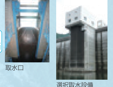
選択取水設備
