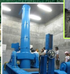
ゲートの開閉機です
