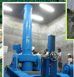
ゲートの開閉機です
