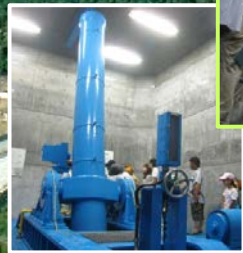
ゲートの開閉機です
