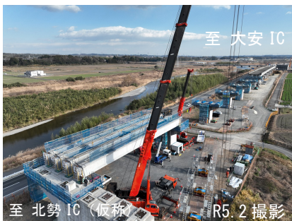
令和6年度開通に向け工事が進む 東海環状自動車道 北勢IC(仮称)～大安IC
