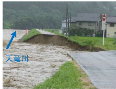
平成18年7月豪雨河岸浸食状況
