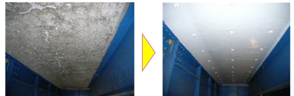
【対策事例】床版コンクリートひび割れ
