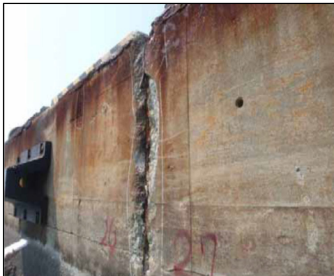
上部工の劣化状況
