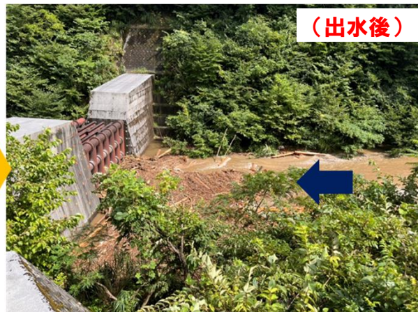
出水後: 令和5年8月16日撮影
