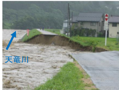
平成18年7月豪雨河岸浸食状況
