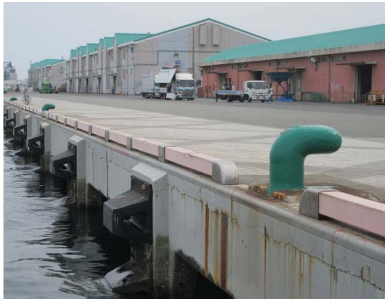
日の出地区 上部工の劣化状況
