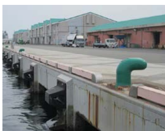
上部工の劣化状況
