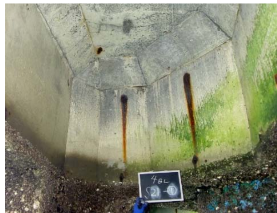
日の出地区 床版の劣化状況
