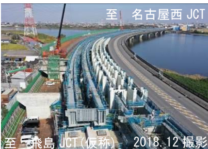
2020年度開通に向け橋梁工事等が進む 名古屋環状2号線 飛島大橋
