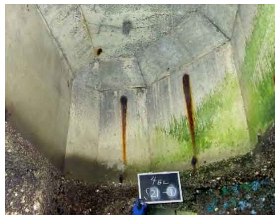
日の出地区 床版の劣化状況
