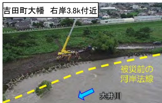
令和2年7月 前線による河岸浸食状況
