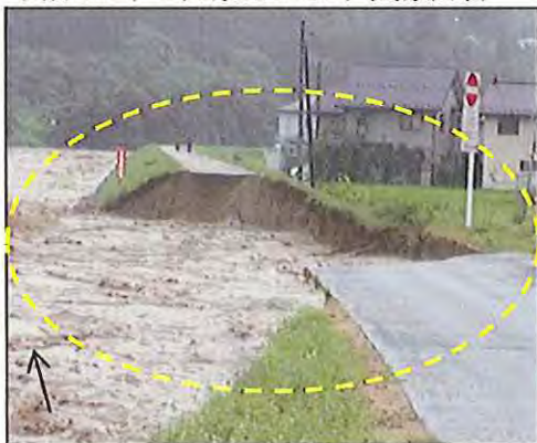
平成18年7月豪雨により堤防決壊
