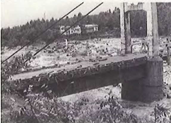
駒ヶ根橋の損傷 (S39年9月台風20号)
