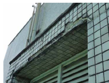
劣化した外壁の状況
