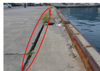
■岸壁前傾による目地開き
