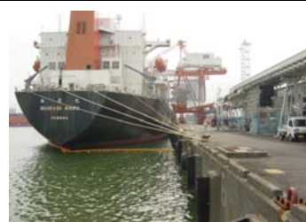
■既存岸壁の老朽化状況
