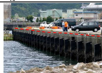
■老朽化による岸壁の沈下
