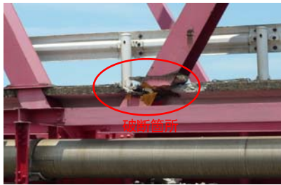
破断の状況 (H19.6.20 破断発見)
