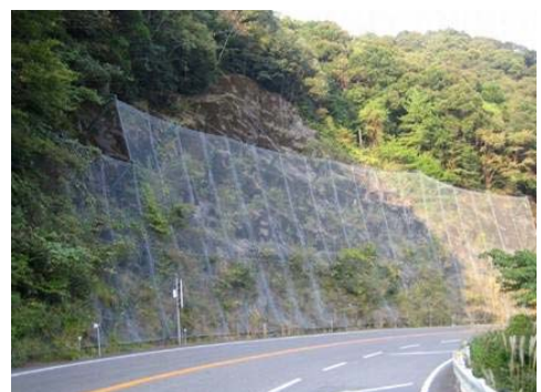
不安定な岩塊 (国道42号熊野市大泊地区)
