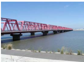
斜材の破断が発生した国道23号 木曾川大橋（三重県木曽岬町）
