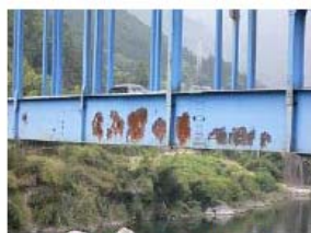
【主桁腐食状況写真】
