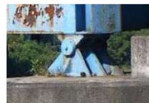
【支承損傷写真】
