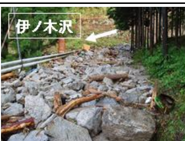
道路に土砂が流出した様子
