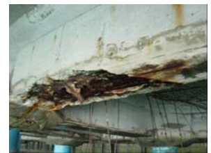
老朽化した港湾施設
