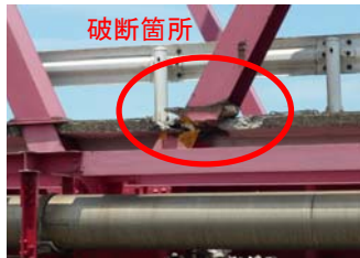
破断後の状況(H19.6.20破断発見)
