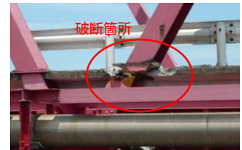
破断後の状況 (H19.6.20 破断発見)
