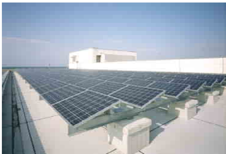
太陽光発電設備設置例
